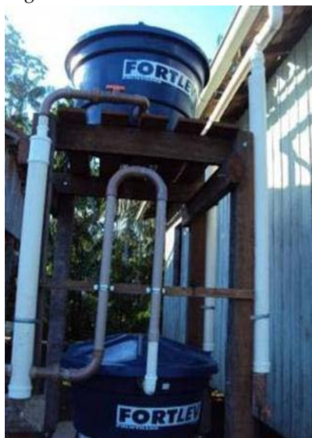
Figura 13b – Sistema na ilha Murutucu.
