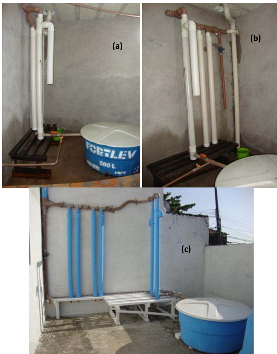
Figura 12 – Sistemas experimentais da UFPA na área urbana de Belém. (a) e (b) 1º. sistema instalado; (c) 2º. sistema instalado.
