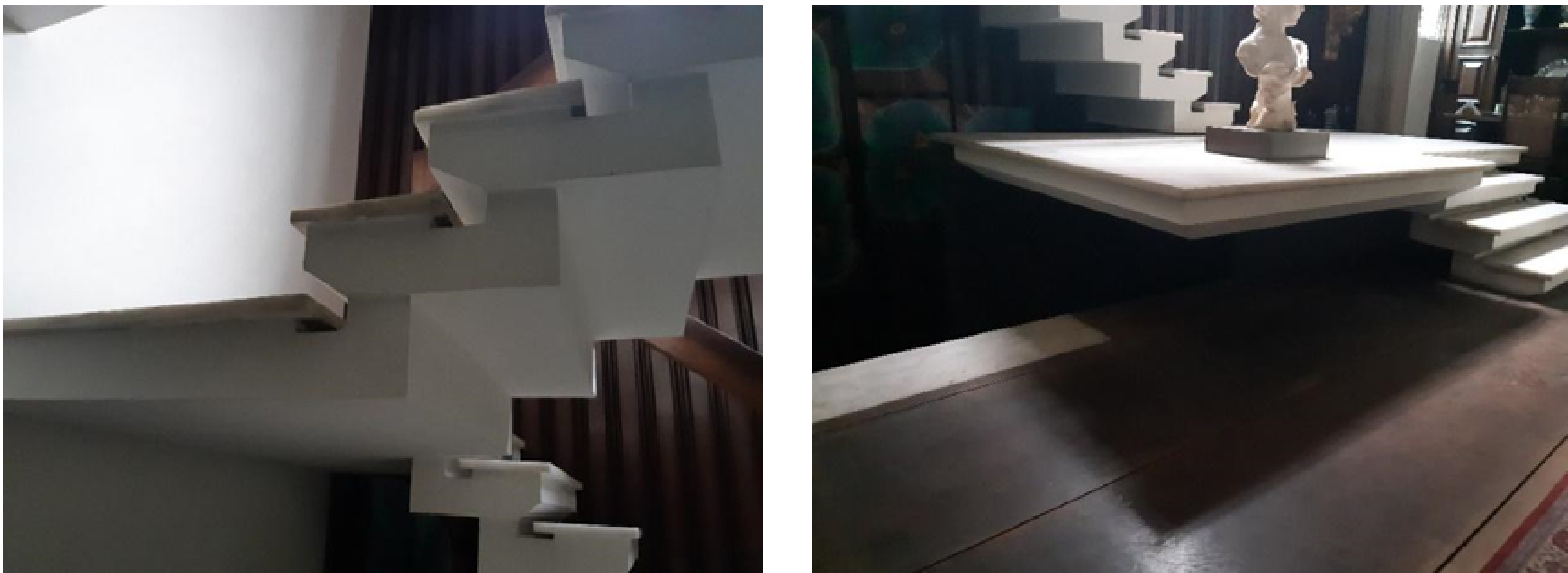
Figura 8: Detalhe dos degraus soltos flutuantes
