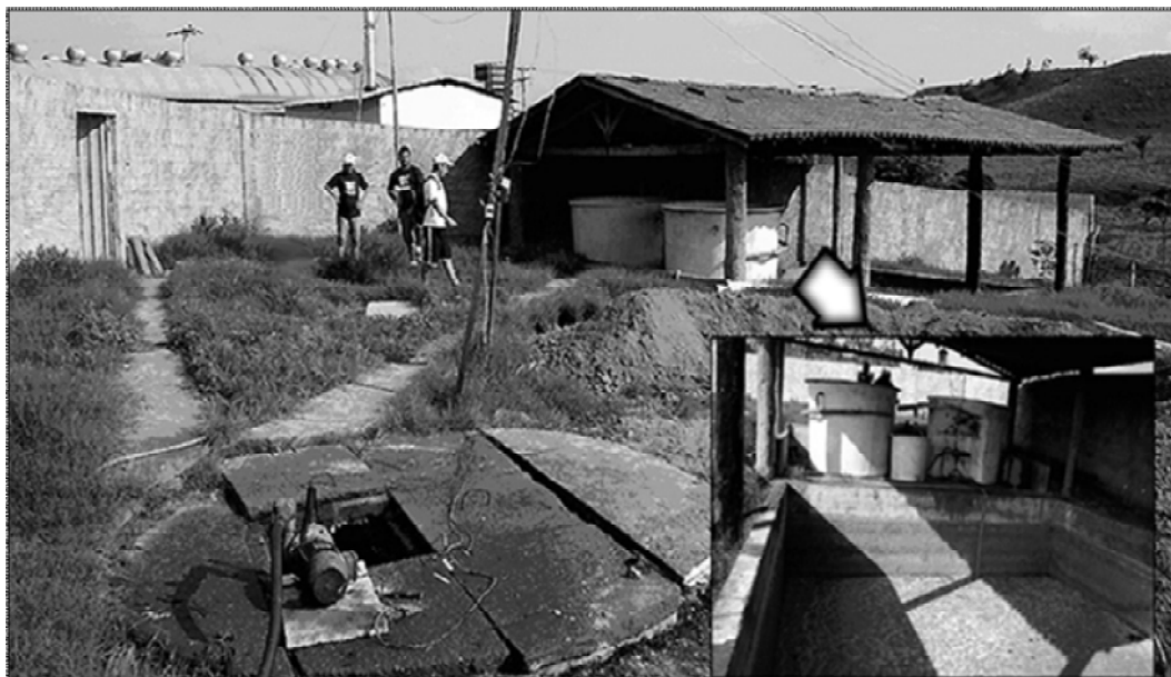
Figura 4 – Visão geral da estação de tratamento de esgoto da indústria.
