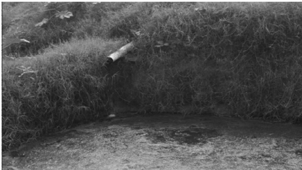
Figura 16 – Sumidouro do matadouro municipal a céu aberto.
