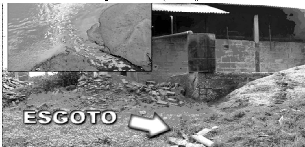
Figura 14 – Tubulação de esgoto.
