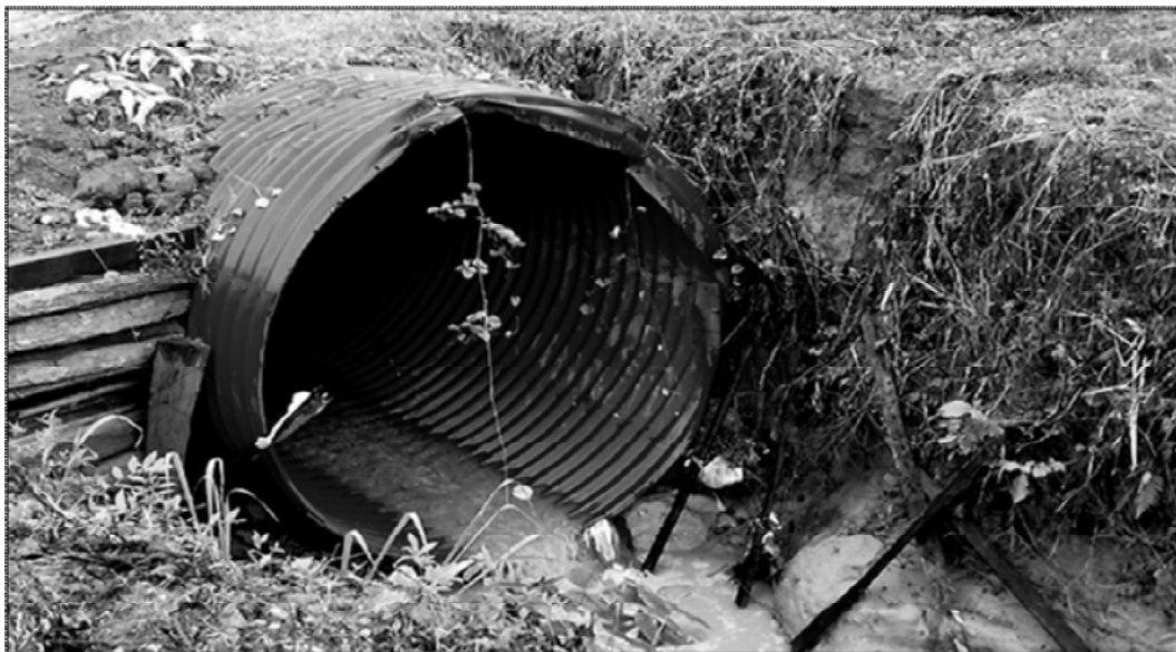
Figura 9 – Rede de drenagem que recebe contribuição de esgotos domésticos.
